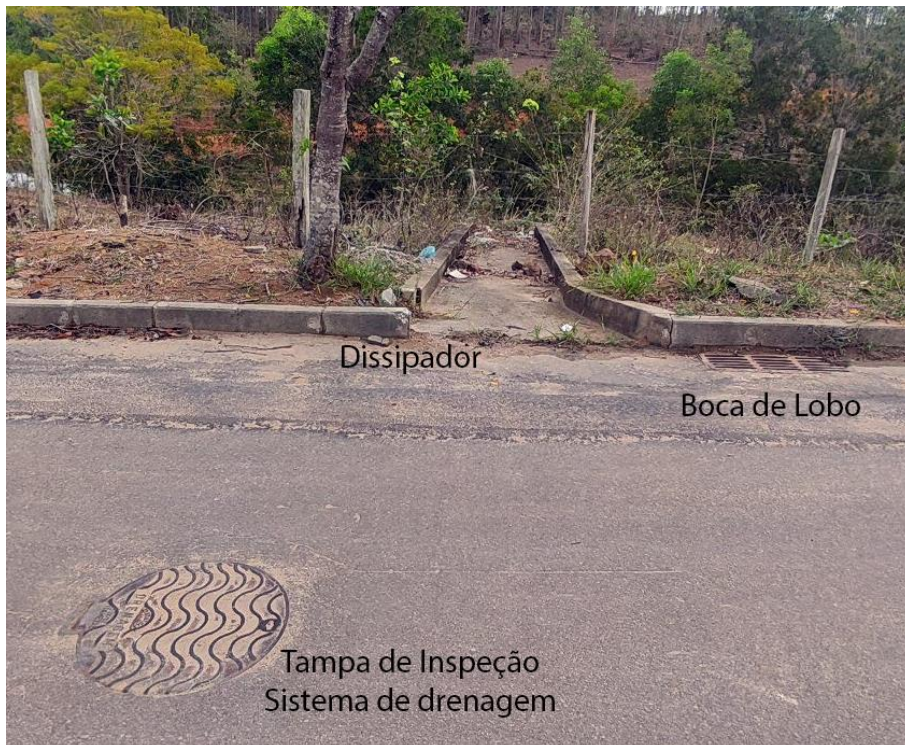
Figura 39: Identificação de boca de lobo e sistema de drenagem pluvial e dissipador da Rua Darcy Ribeiro com Paulo Freire.
