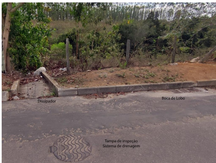
Figura 41: Identificação de boca de lobo e sistema de drenagem pluvial e dissipador da Rua Darcy Ribeiro com Rua Cecilia Meirelles.
