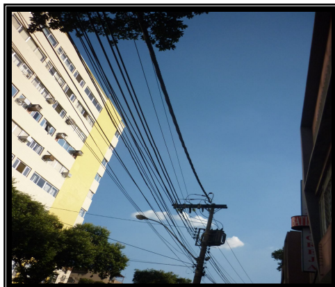
Figura 22: Rede Isolada ou Multiplexada, Rua Afonso Pena, Gov. Valadares - Minas Gerais.
